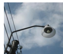
Åbent armatur på træmast med luftledninger
